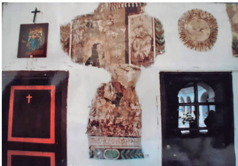
Fig. 41. Estado de conservación de los murales antes de las intervenciones del 2004. Tomado de (INPC, 2004. Fichas de inventario DIN-FGC-00214 y 00215).
